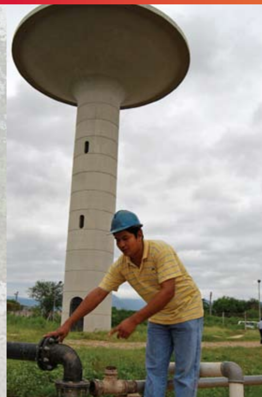
El tanque elevado de almacenamiento de agua en Camiri tiene una capacidad de 300 metros cúbicos.
