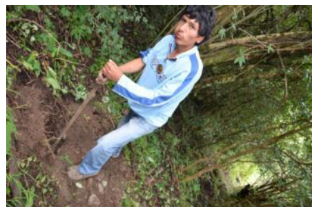
En la foto: un joven estudiante de Villa Serrano, realiza la perforación para la inserción posterior de los postes de protección (el terreno es una pronunciada pendiente).
