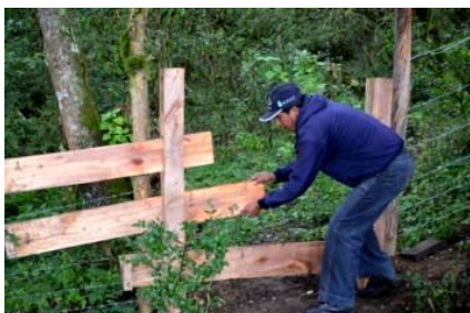
En la foto: el Ingeniero Elías Avendaño, del gobierno municipal de Villa Serrano, abre el ingreso a uno de los “cerramientos”, realizados para proteger la fuente de agua.
