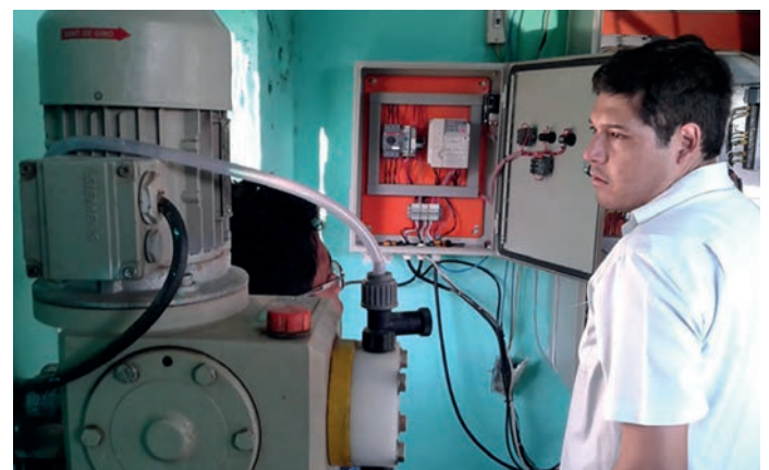
Automatización de bomba dosificadora mediante variadores de frecuencia. Fuente: elaboración propia.
