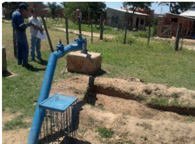
Pozo de bombeo directo a la red. Fuente: SAJUBA.
